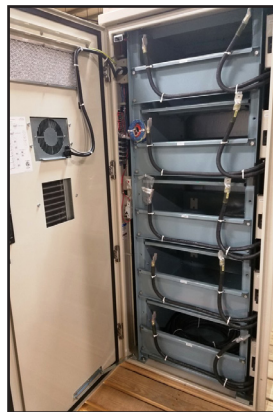
CUBE-BB48E2EV1 Front Door Open
