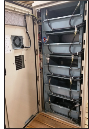
CUBE-BB48E2EV1 Front Door Open
